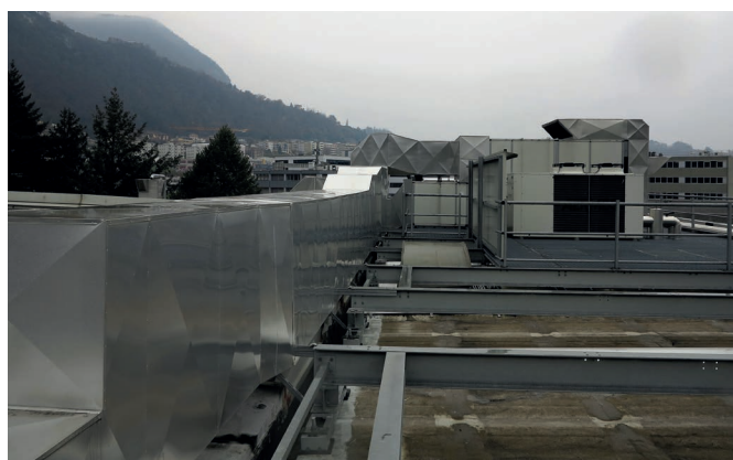
Impianto di ventilazione sul tetto. Foto: Márton Varga, Topmotors
