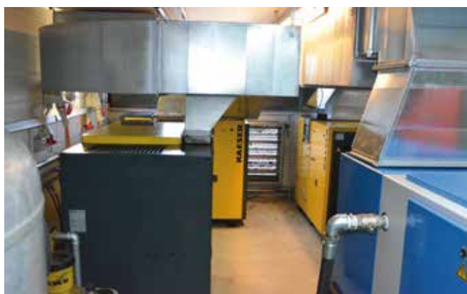
Quattro vecchi compressori nel locale tecnico. Foto: Alain Chappatte, Energie du Jura
