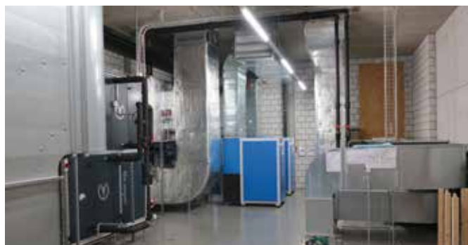
Due nuovi compressori nell'ampio locale tecnico per l'aria compressa. Foto: Márton Varga, Topmotors
