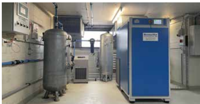
Stesso locale tecnico, con solo un nuovo compressore. Foto: Michael Broccard, Schrad'air Compresseurs SA
