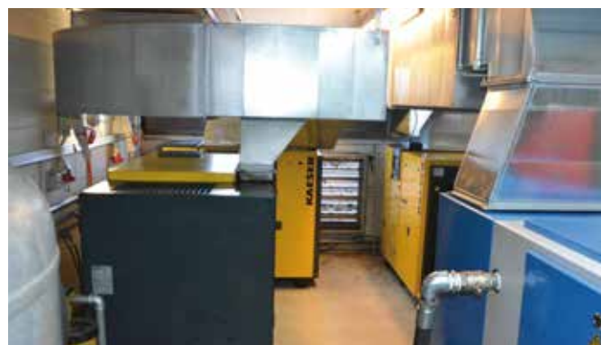
Quatre anciens compresseurs dans l'ancien local technique. Photo: Alain Chappatte, Energie du Jura
