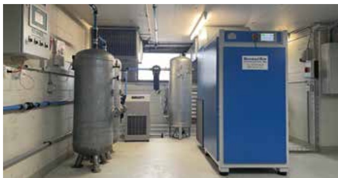
Le même local technique, avec un seul nouveau compresseur. Photo: Michael Broccard, Schrad'air Compresseurs SA
