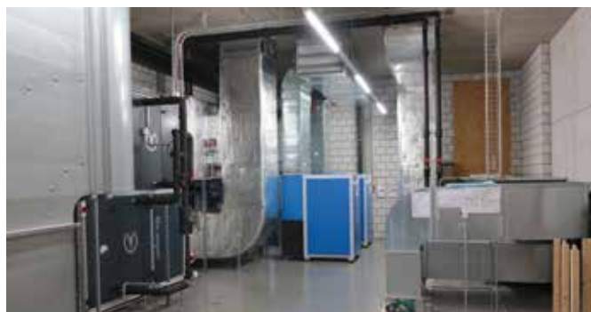
Deux nouveaux compresseurs dans le vaste local technique. Photo: Márton Varga, Topmotors
