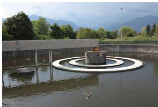
Vasca di decantazione finale dell'IDA Foce Maggia.
