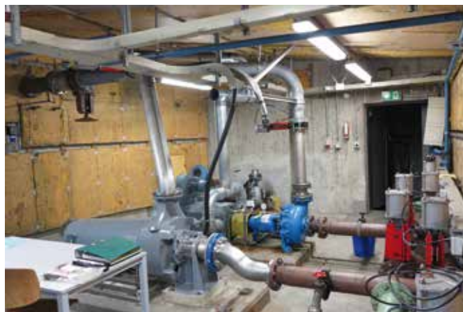
La stazione di pompaggio con le due pompe per fanghi.
