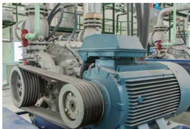
Sistema di refrigerazione industriale
