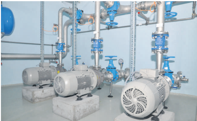
Die drei neuen Pumpen in Blockbauweise mit elektrischen Motoren à 15 kW Leistung haben den IE4-Standard. Das Unternehmen IVF HARTMANN AG spart mit ihnen CHF 8000 Stromkosten im Jahr; der Payback beträgt 4 Jahre. (Bild S. Hartmann)
