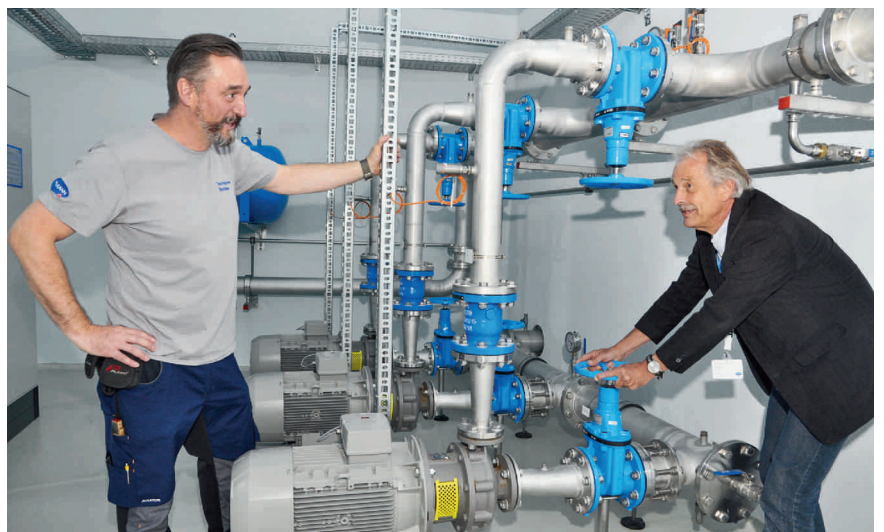
Stephan Hamm (l.), Projektleiter der Technical Services der IVF Hartmann AG, sowie Jürg Meier, Projektleiter des neuen Pumpenwerks (Fotos: S. Hartmann)
