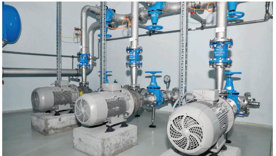
Rund 53 000 kWh weniger Stromverbrauch pro Jahr dank drei effizienteren, horizontalen einstufigen Spiralgehäusepumpen in Blockbauweise
