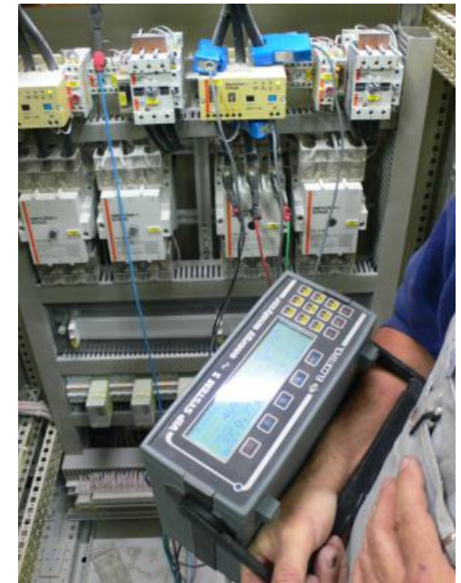
Elektr. Leistungsmessung mit Stromzangen
