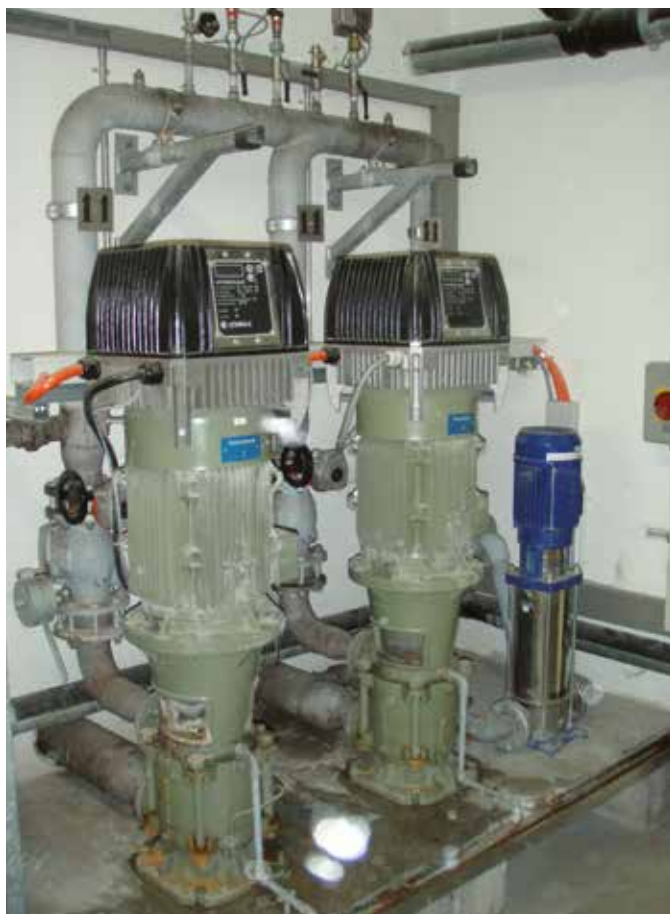
Ancienne installation haute pression avec 2 pompes Häny 4504/3 (de 1992) et 1 pompe Lowara SV808 pour le maintien de pression (2001).
