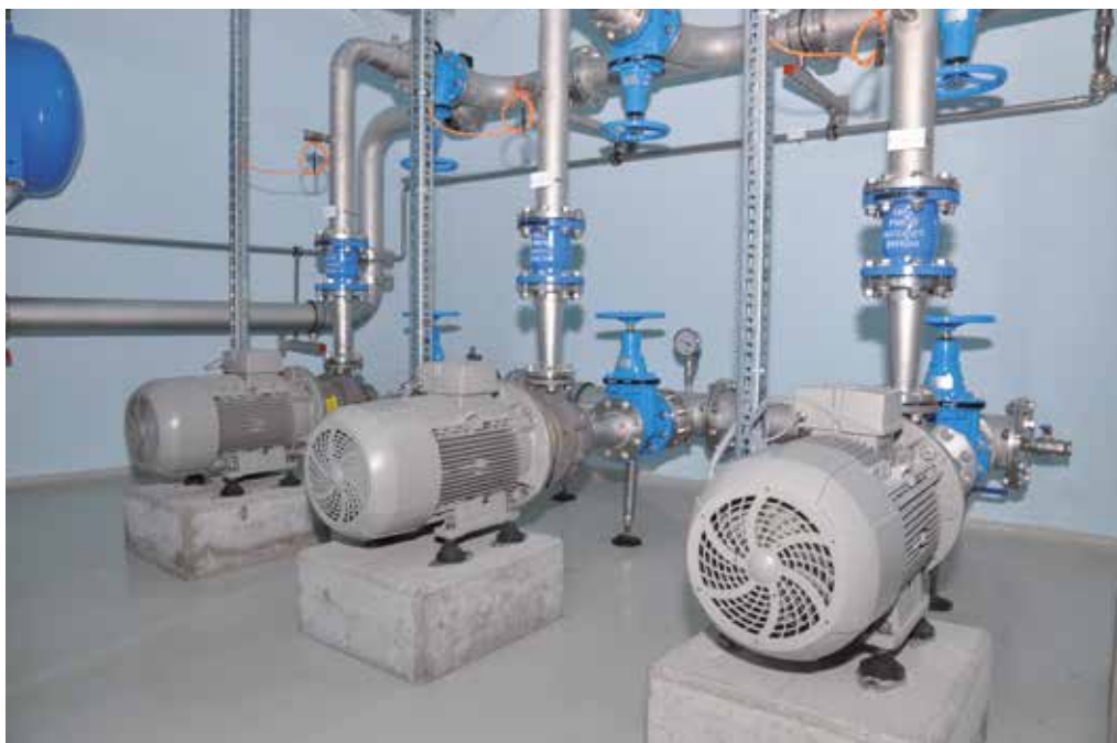
Nouvelle usine avec installation redondante de pompes et tuyauterie rénovée. Photo: Stefan Hartmann, Presseladen.
