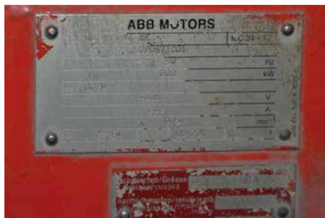
Moteur ABB, année de construction 1990, 200 kW, 6 pôles et 995 tours par minute
