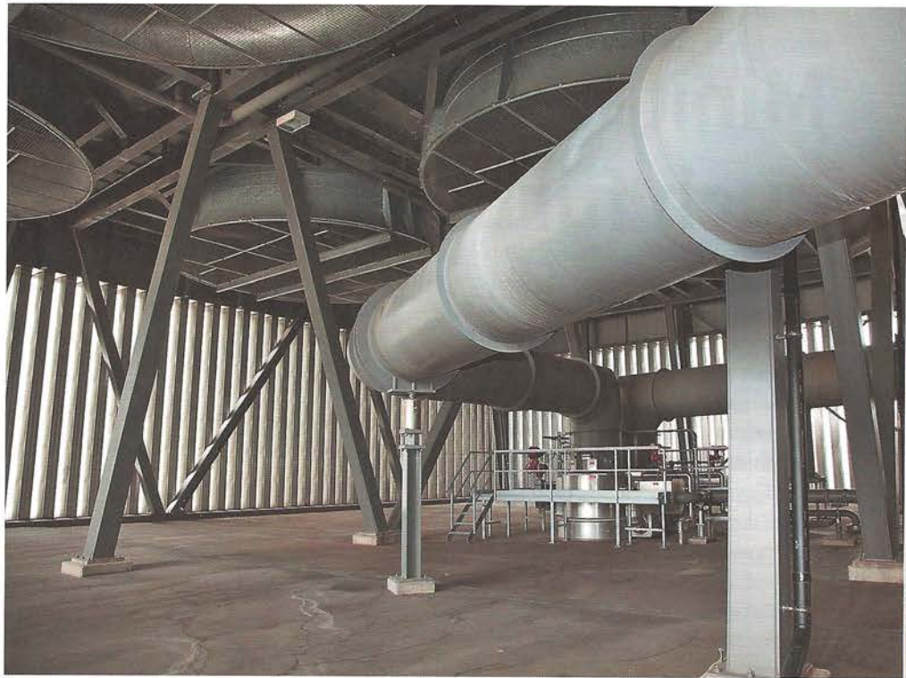
Bei öffentlichen Infrastrukturanlagen soll das Energiemanagement verstärkt werden.
